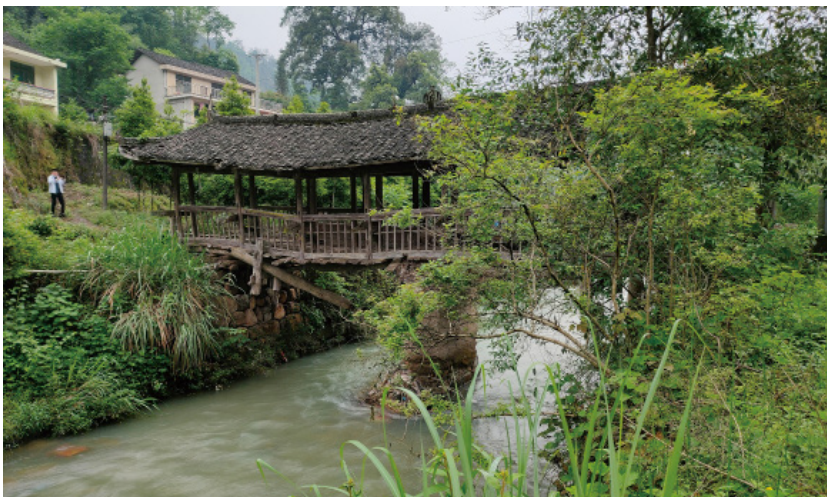
平口镇濠佳桥木抬梁已出现朽断成为危桥
